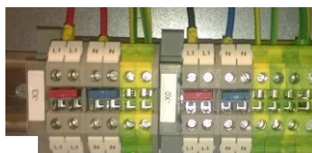
Terminales de entrada y salida de poder
