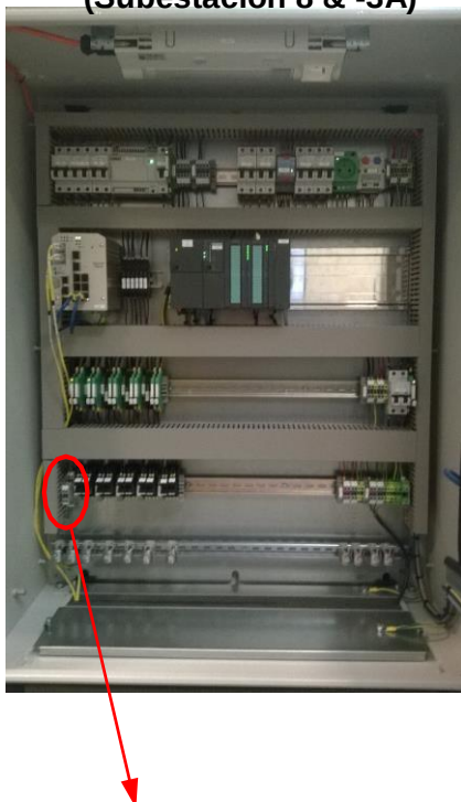
Gabinete ALCS con conector Jbus (Subestacion 8 & -3A)
